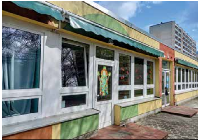
Das Gebäude der Kita Schwalbennest ist sanierungsbedürftig. Foto: jm
